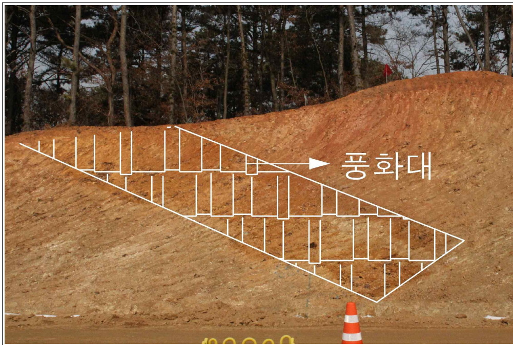
【그림 9】 A 영역 발달한 풍화대(STA.3+670~680)
